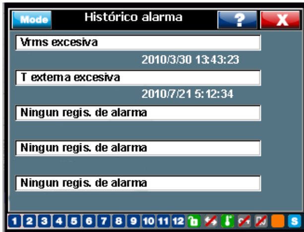
Figura 50: Control batería histórico alarma
