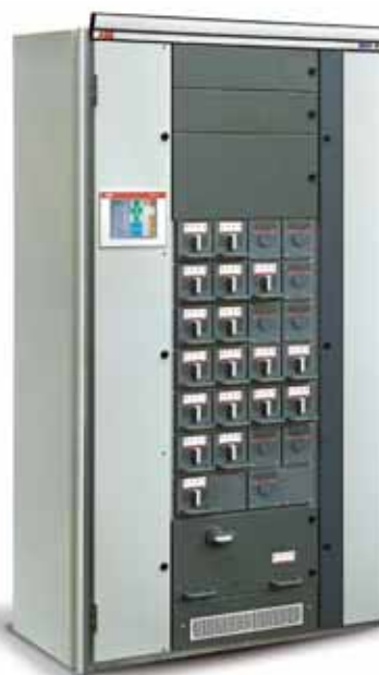
Figura 4: Vista de conjunto de un centro de control de motores (MCC)
