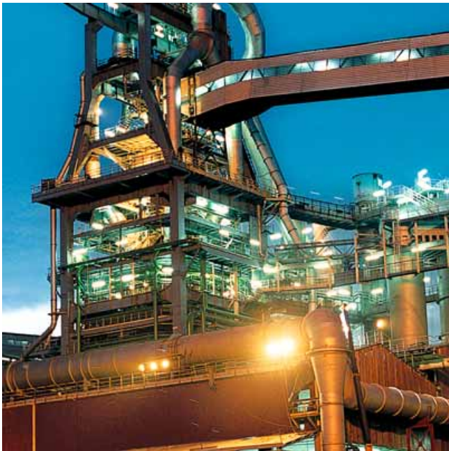
Aplicación industrial: Refinería
